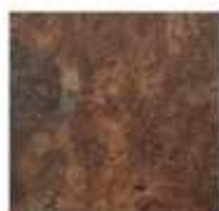
Oxido rost 7mm
